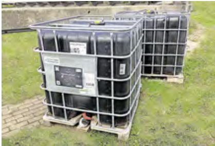
Die flüssige Nanocarbon wird in die Belebungsbecken dosiert.
