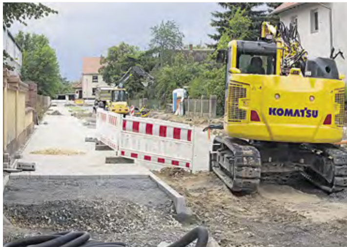
Vor jedem baulich bedingten Eingriff ins Erdreich muss eine Schachtgenehmigung beantragt werden. Sie soll das Beschädigen unterirdisch verlegter Leitungen verhindern.
